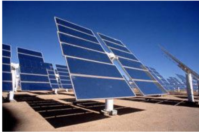
Figure I.1. Les panneaux solaires.
