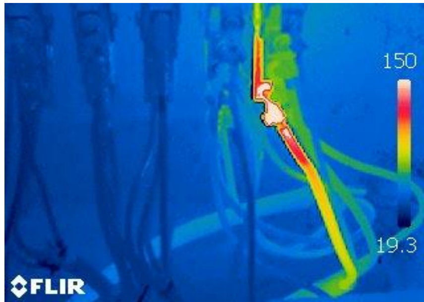
Figure III.24. Câble de connexion
