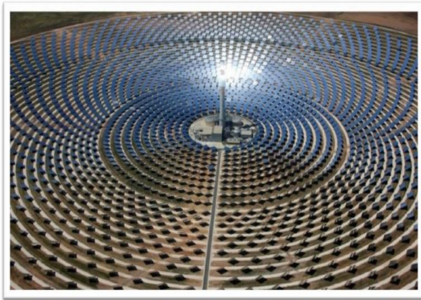
Figure II.24 : Centrale solaire à Concentration (CPV), puissance 19,9 GW, Seville
