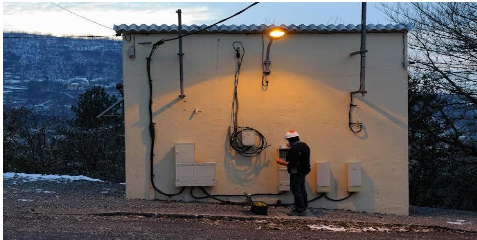
Figure I-8: Accident d'origine électrique. [13]
