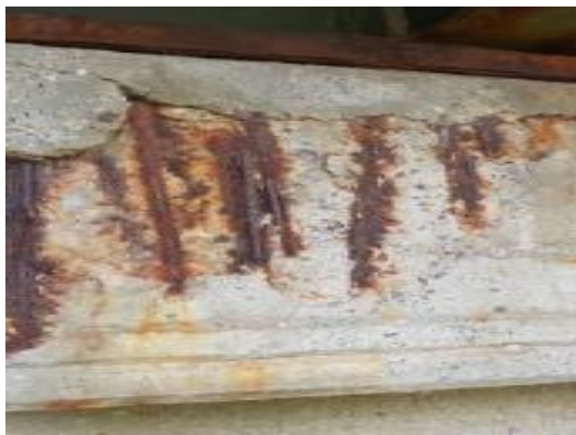
Figure 1-6 : Corrosion du béton
