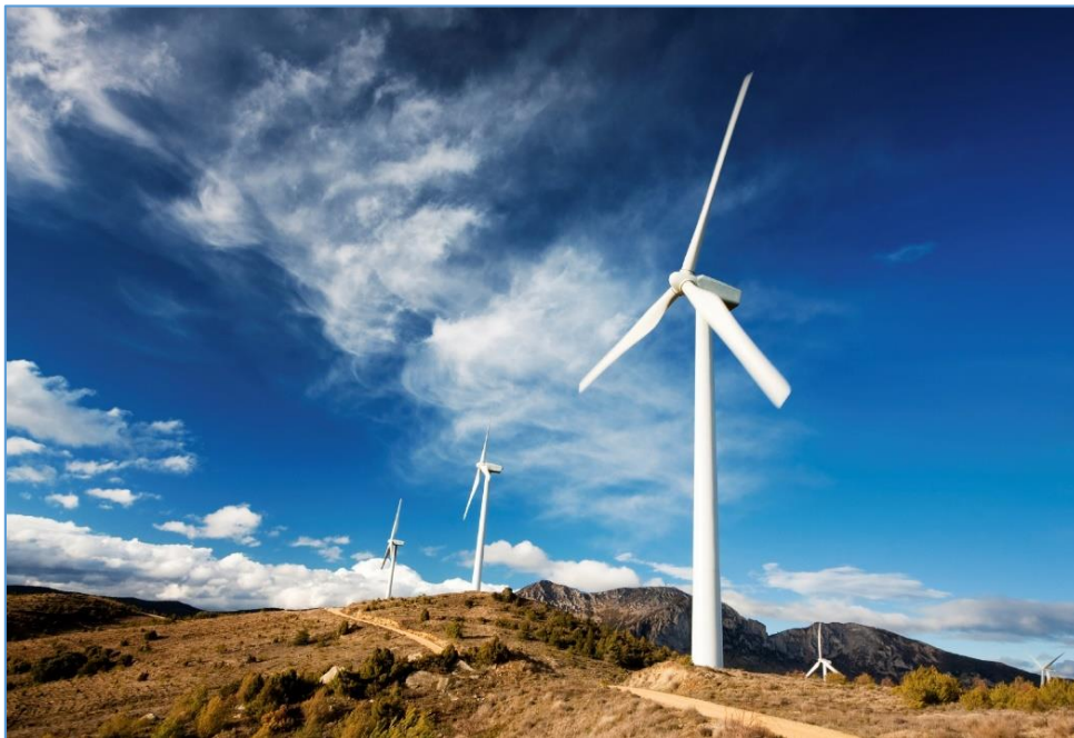
Fig I.6- Photo d'une centrale éolienne.
