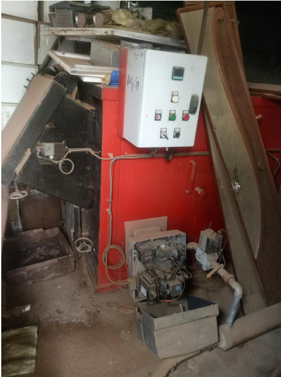
Figure 41: Incinérateur en Panne dans l'hôpital Frenda (photo originale 2022)
