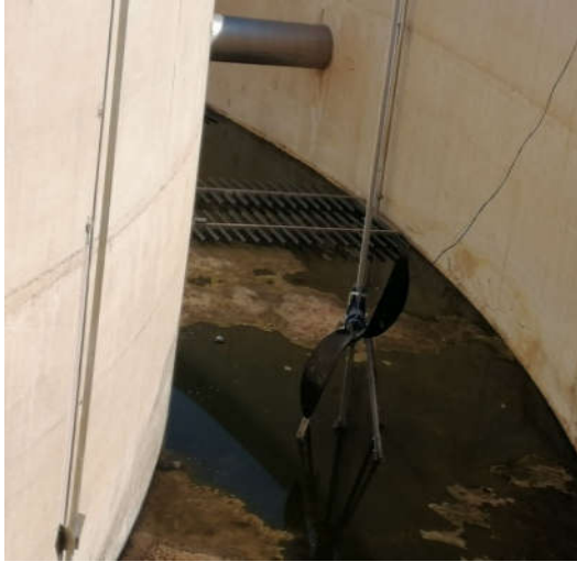
Figure 03 : Photo d'un aérateur de la STEP de la ville de Tiaret (Photo originale, 2021).
