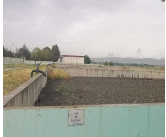
Figure 08 : Photo du lit de séchage des boues de la STEP de la ville de Tiaret (Photo originale, 2021).
