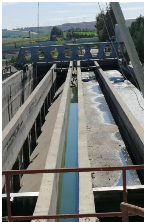
Figure 09: Photo du déssableur/déshuileur de la STEP de la ville de Tiaret (Photo originale, 2021).
