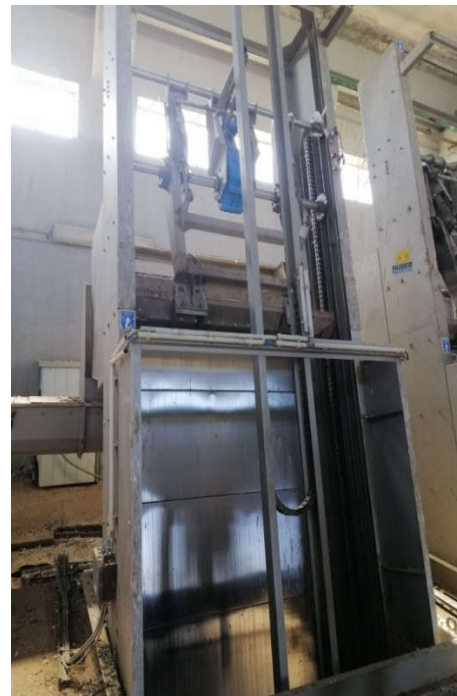
Figure 10 : Photo du dégrilleur de la STEP de la ville de Tiaret (Photo originale, 2021).
