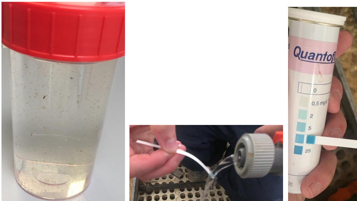
Figure 33 : A gauche : cette eau trouble et pleine de particules de biofilm ne devrait pas être distribuée à des jeunes poulettes ; Au centre et à droite : évaluation de la concentration de peroxyde en bout de ligne après traitement de l'eau (C. Misslin)
