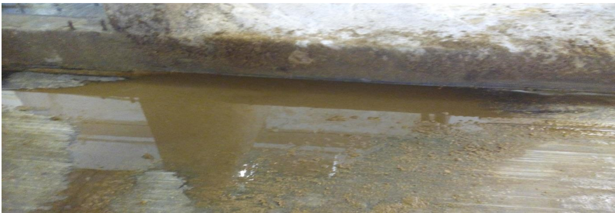
Annexe 2 : sol humide (présence de flaques d'eau)
