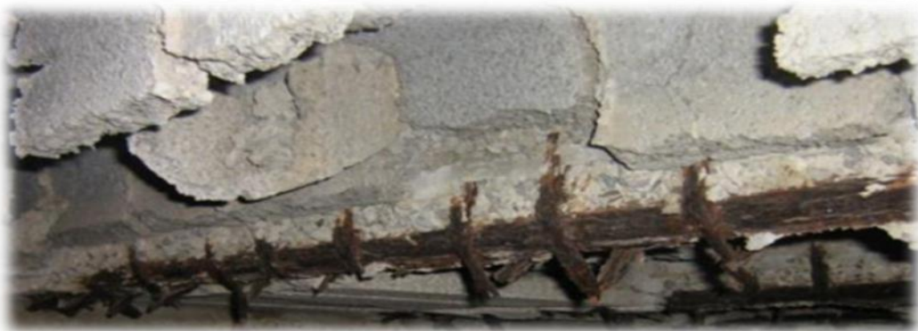
Figure.I.6 : Corrosion avancée des armatures des poutrelles. [12].
