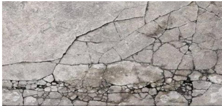
Figure.I.8 : Fissuration du béton [16].
