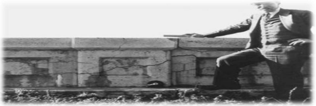
Figure I.3 : Fissures causées par la Réaction Alkali-Silice rapporté par Mehta [3].
