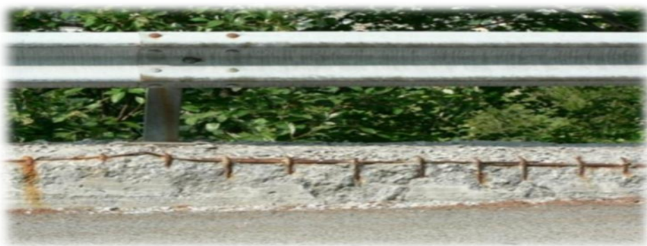
Figure.I.7 : Effet du gel-dégel sur le béton : écaillage du béton d'enrobage et corrosion des armatures. [14]
