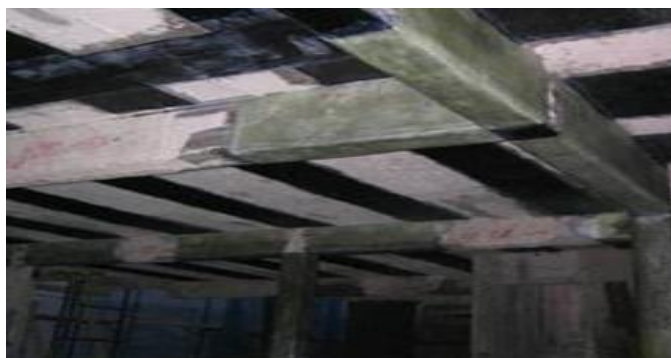
Figure.III.3 : Renforcement par Tissu en Fibres de Carbone TFC d'une poutre en béton armé. [76]
