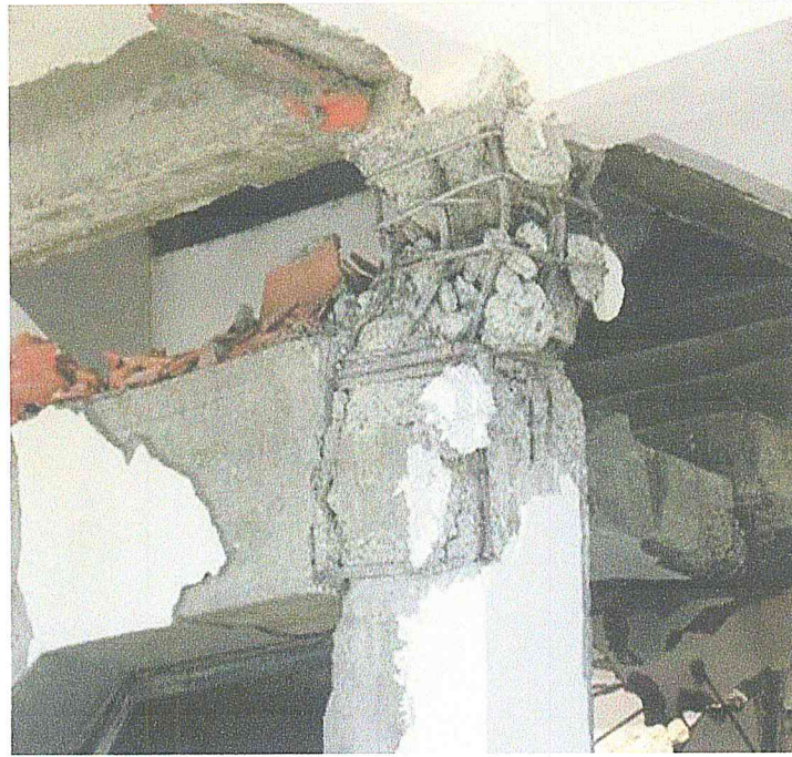
Figure I.25 : Rupture de poteau (cage d'escaliers)
