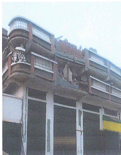
Figure I.22 : Ruine partielle des étages supérieurs
