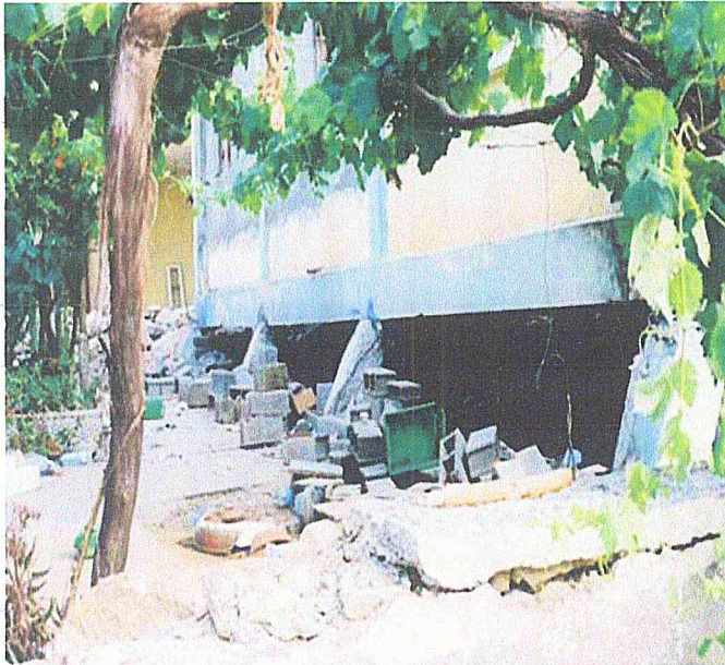
Figure I.23 : Rupture de poteau (vide sanitaire)
