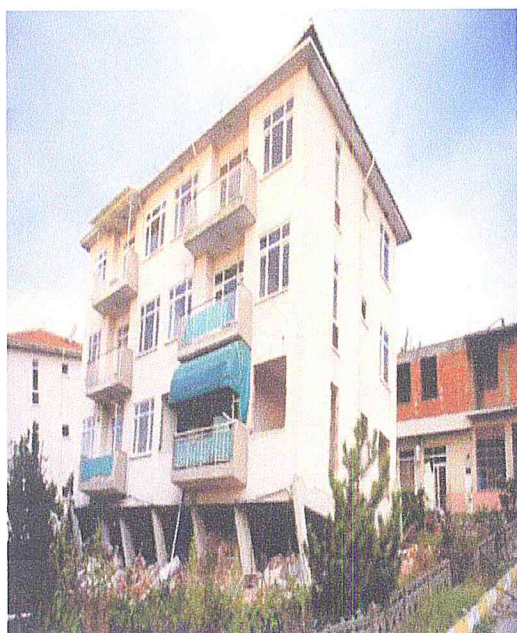
Figure I.21 : Etage souple au niveau du RDC
