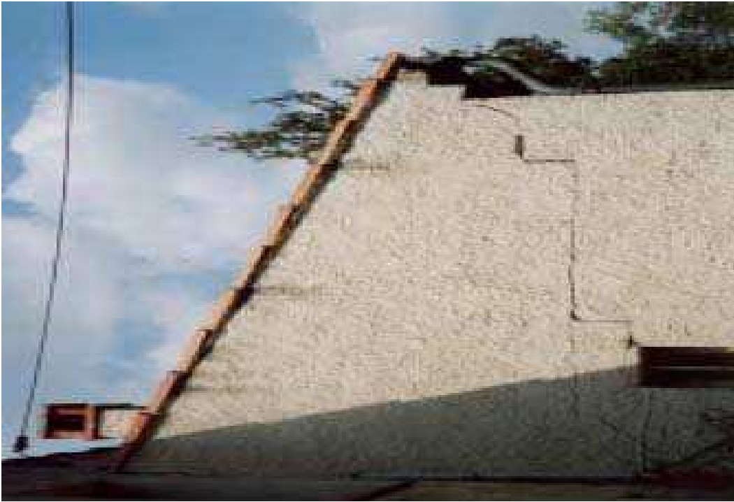
Figure 1.5: fissures au niveau d'une structure de génie civil
