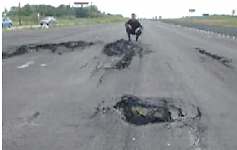
Figure 2.5: Déformation d'une chaussée de sol instable
