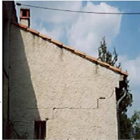
Figure 2.4: Fissures au niveau d'une structure de génie civil
