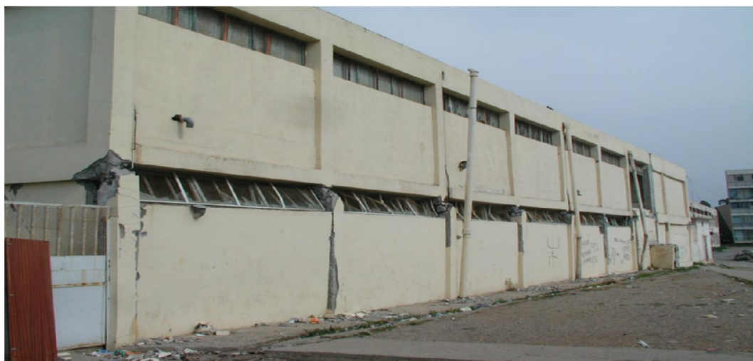
Figure I. 21 : Cas des poteaux courts sans protection – tous les poteaux sont cisailés.
