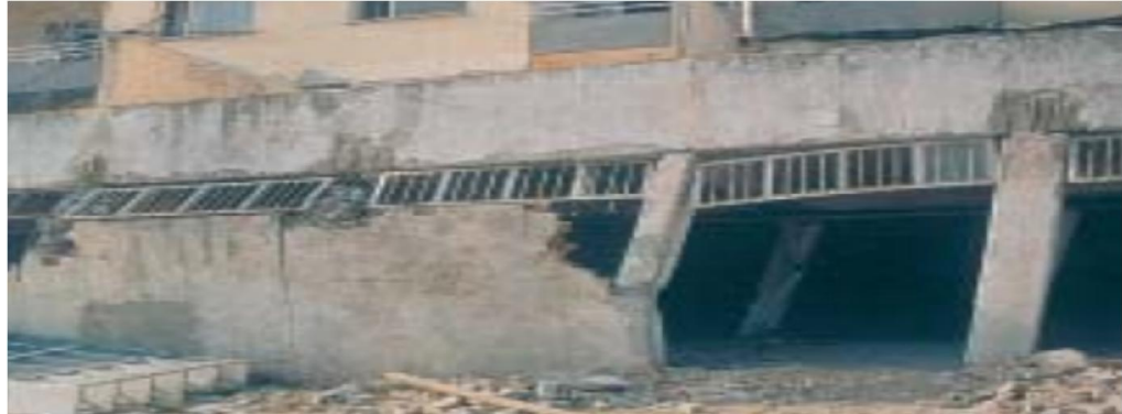
Figure I. 22 : Cas de remplissage partiel d'un portique (Izmit, Turquie 1999)
