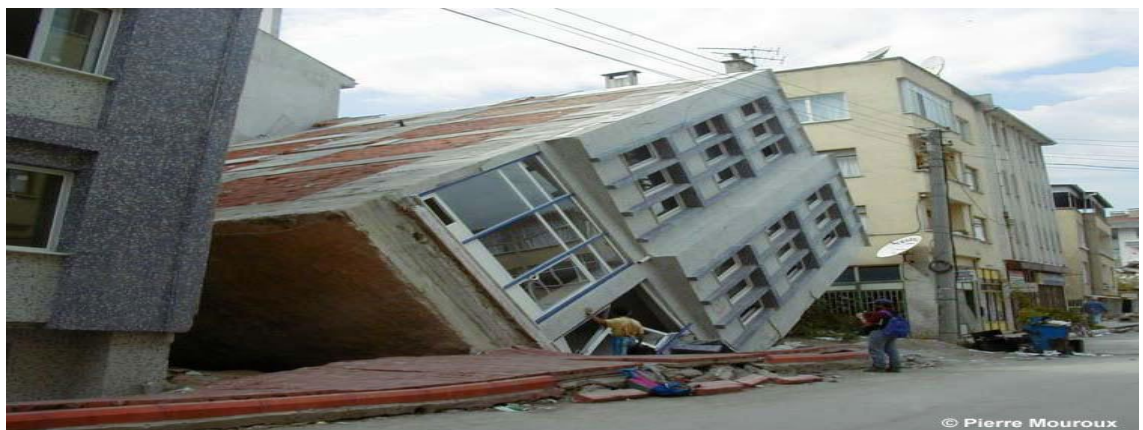
Figure I. 10 : Dommages dus à la liquéfaction des sols (© Pierre Mouroux) Izmit, Turquie 1999
