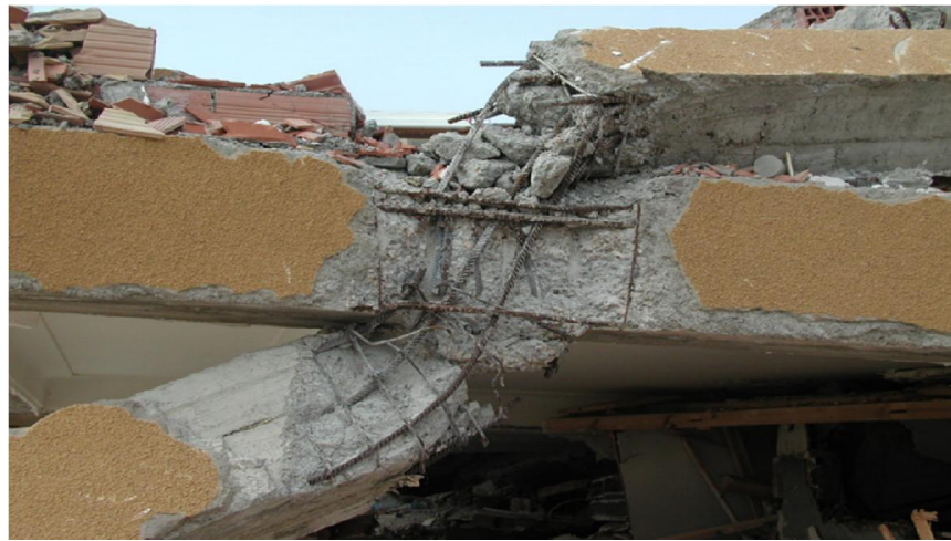
Figure I. 20 : Rupture en zone nodale.
