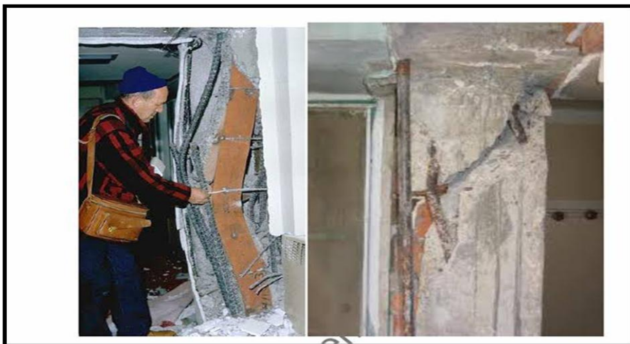
Figure. I .9 : Flambement d'un poteau en béton armé
