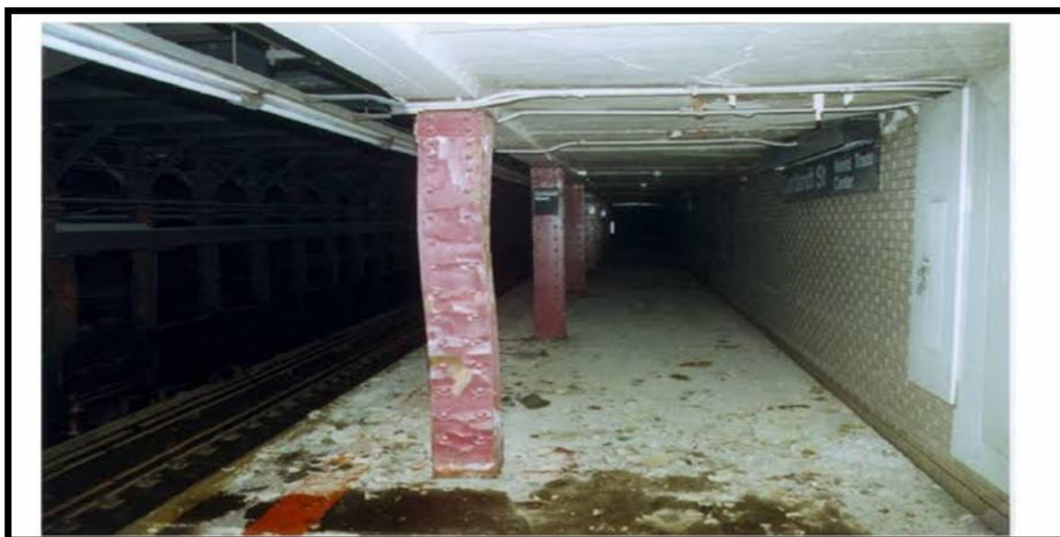
Figure. I .8 : Flambement d'un poteau
