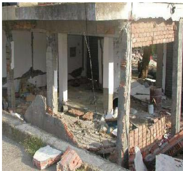
Figure . I .20 : portique en béton armé après le séisme
