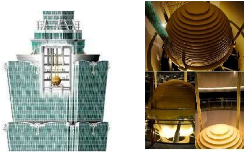
Figure 1.13. Un TMD pendulaire de 800 tonnes dans un bâtiment de 508 m de hauteur (tour de Taipei 101)
