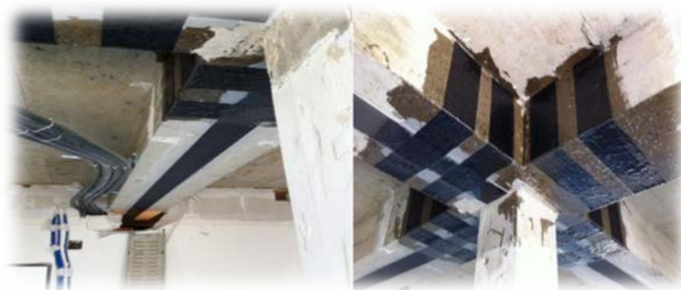
Figure II.25 : Poutres en BA renforcées par matériaux composites.
