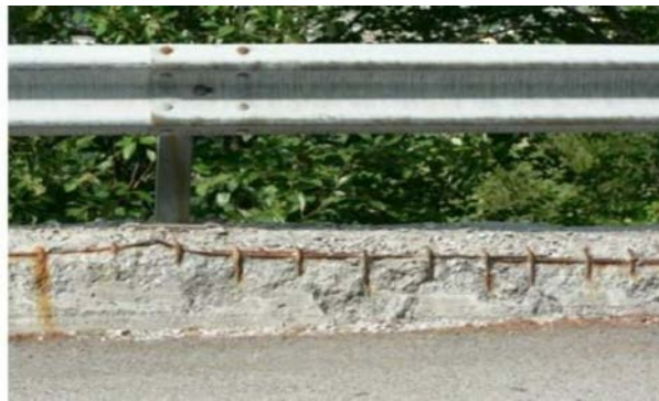
Figure I.2 : Effet du gel-dégel sur le béton : écaillage du béton d'enrobage et corrosion des armatures (Boutaraa.Z.2019)
