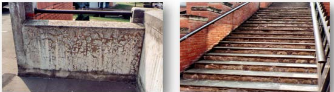
Figure I.4 : Le faciès le plus fréquent est la fissuration en réseau.
