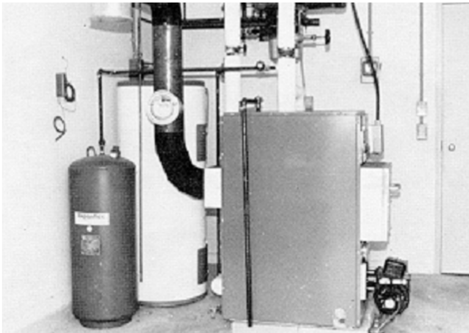
Figure 10 : chaudière au mazout et à circulation d'eau chaude servant au chauffage des éleveuses. ( Station de recherches Kentville)
