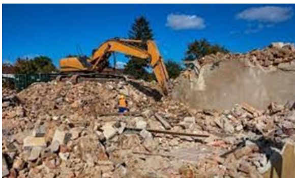
Figure (II. 2) Déchets de la démolition
