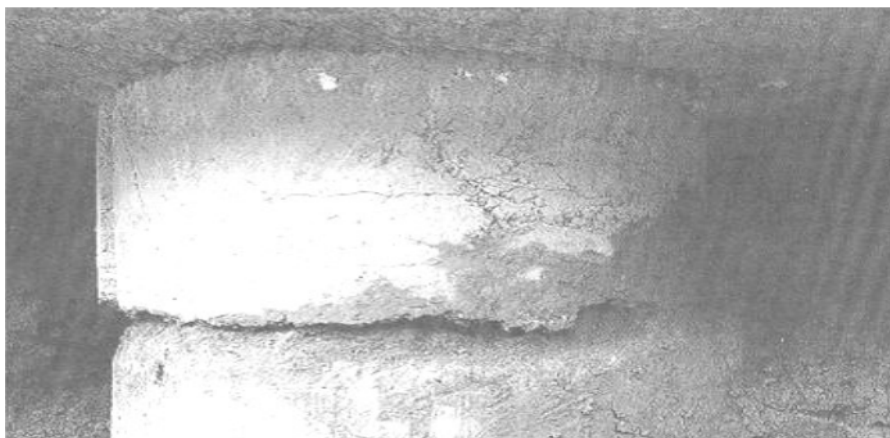
Figure II. 4 : Dommages observés sur une tête de pieux. (Tirée de STOA (STOA et coll., 1999))
