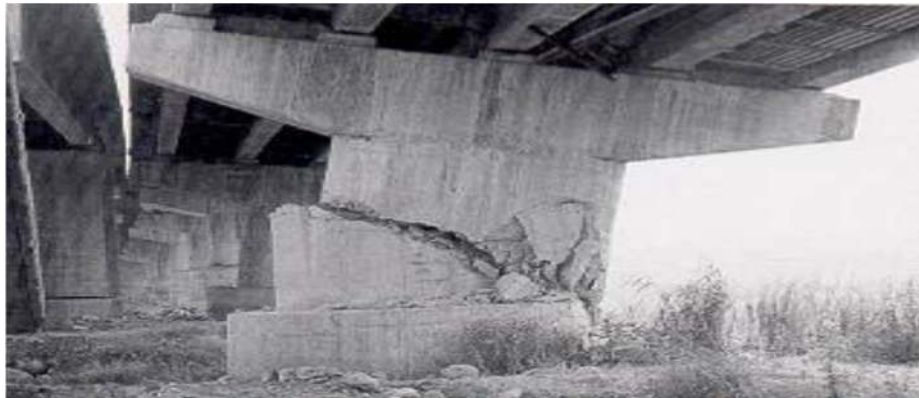
Figure II. 3 : Rupture des piles par cisaillement. (Tirée de Tiré de CTOA (1999))
