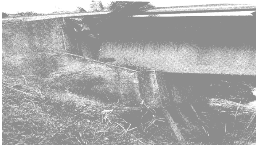
Figure II. 5 : Glissement des culées. (Tirée de Priestley et coll. (1996))
