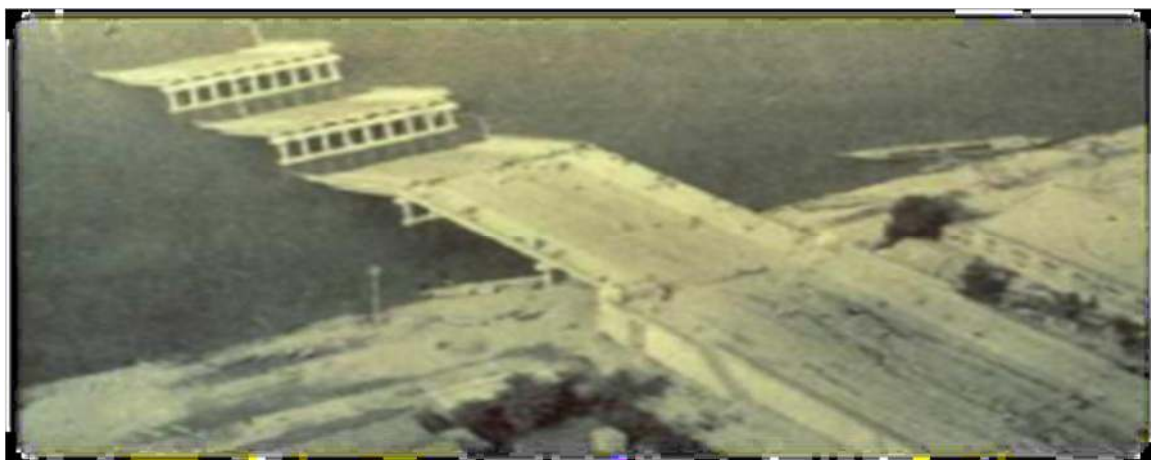
Figure II. 6 : La liquéfaction et tassement des sols lors des séismes de Niigata (Japon) 1964
