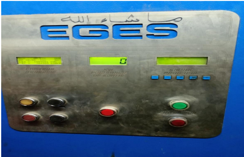
Figure IV. 13 Armoire électrique four EGES
