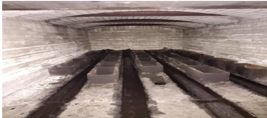
Figure I.5 Four de traitement thermique
