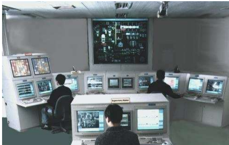
Figure 1.2 : Poste de pilotage d'une supervision.
