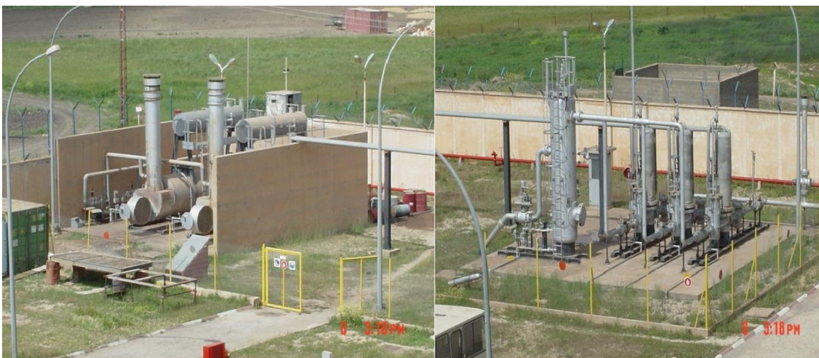
Figure II. 2 : Poste à gaz.
