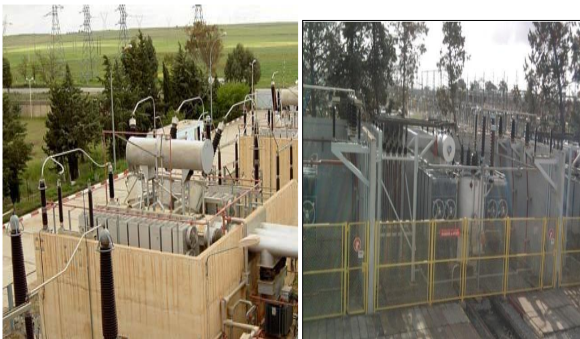
Figure II.20 : Transformateur ALSTHOM & Fiat.
