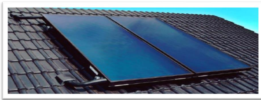
Figure I.2 : Panneau solaire thermique.
