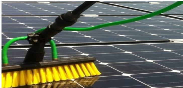
Figure IV.24 : Le nettoyage de panneau solaire.
