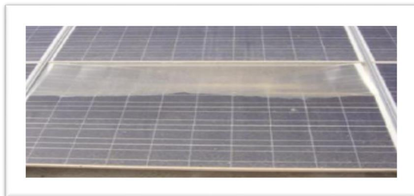
Figure III.5 : défaut de délaminage.
