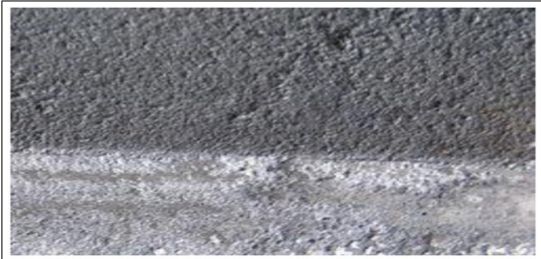
Fig. II-14 : Défaut de surface rugueuse
