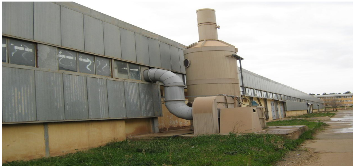
Figure III .7: Aspirateur de gaz acide.
