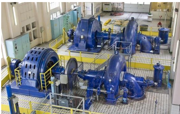
a: Centrale hydro-électrique (Turbine hydraulique + Alternateur)
