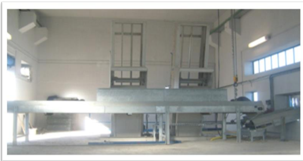
Figure 5: Dégrilleur grossier (photo Personnale, 2019)
