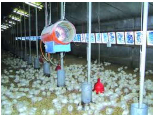
Figure08 : chauffage au mazout
