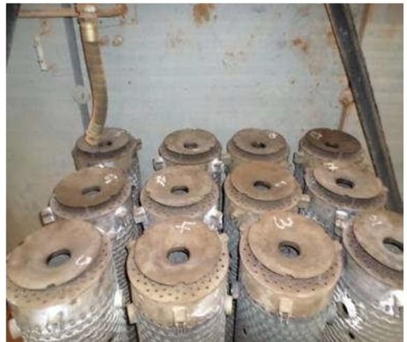
Figure 5.22 : Tubes à flamme démontés.
