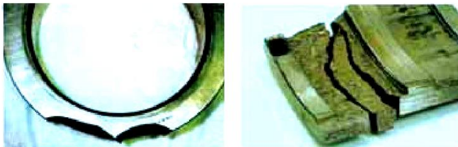
Figure III.7: Fissure et cassure des bagues.
