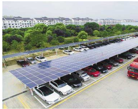
Abri solaire de parking
