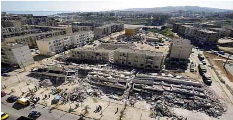
Figure I.1: Séisme de Boumerdes (2003)
