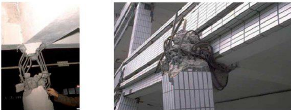
Figure I-7 : Eclatement de zones critiques, extrémités des poteaux et poutres.
