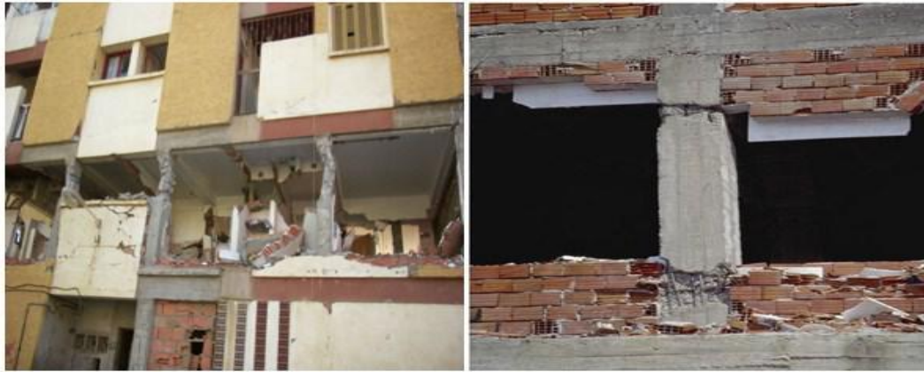
Figure I-6 : cisaillement des poteaux courts.
