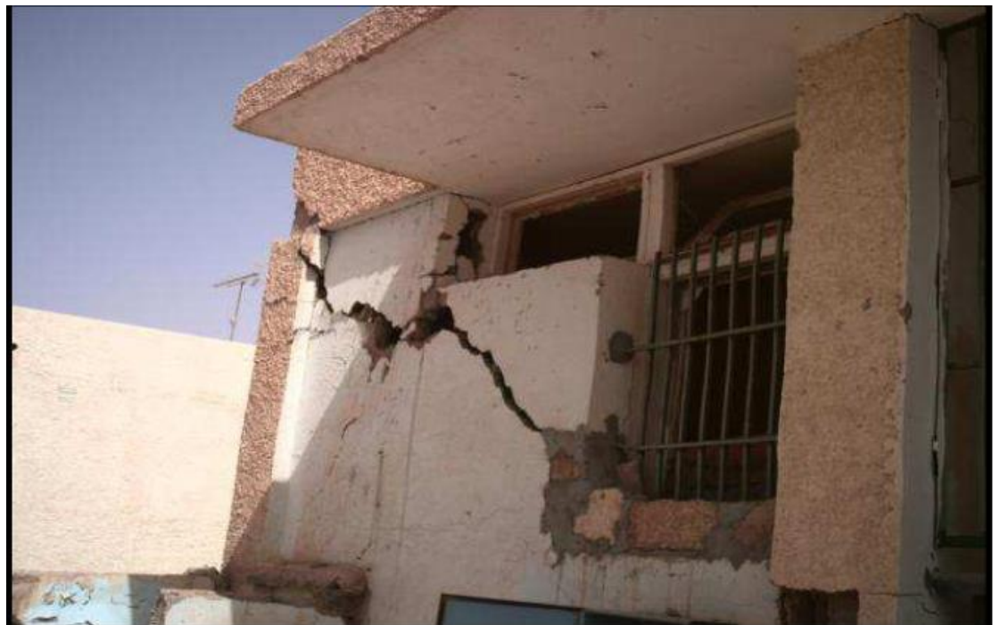
Figure.I. 26 Fissure sur les murs [22]
