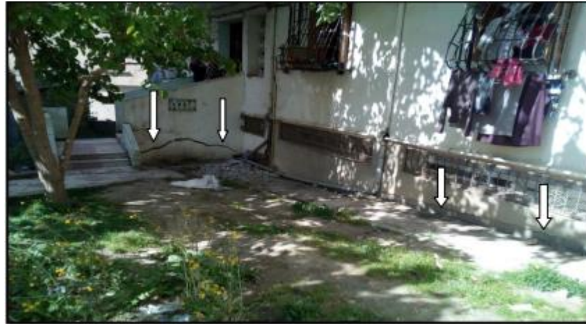
Figure.I. 25 Dégradations et fissurations des façades des bâtiments (Photo prise à Tizi-Ouzou)
