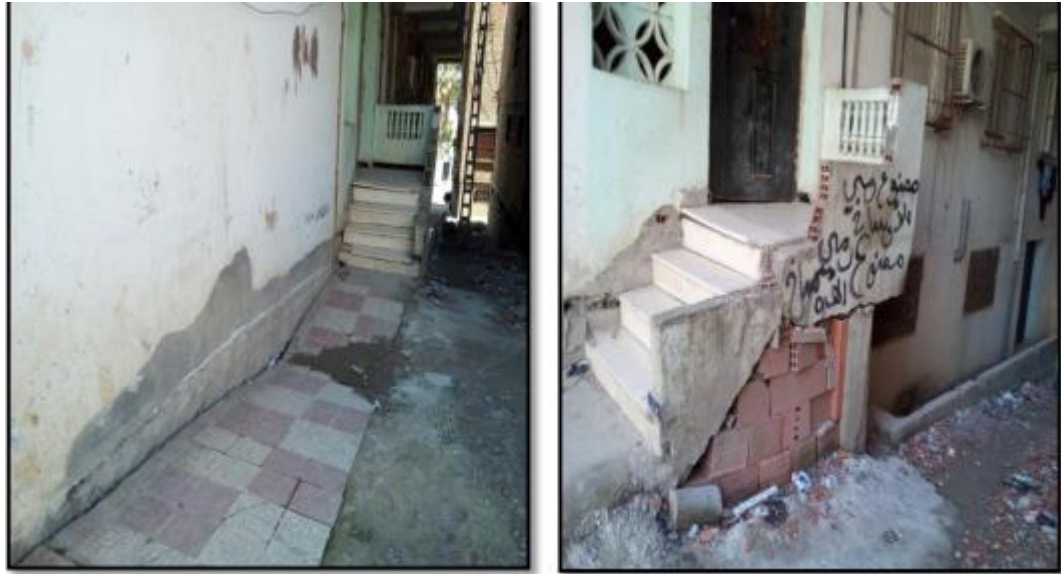
Figure.I. 27 Désordres due au gonflement(Photo prise à Tizi-Ouzou)
