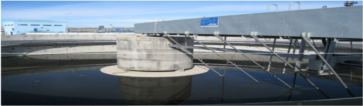
Photo V. Bassin de décantation primaire.
