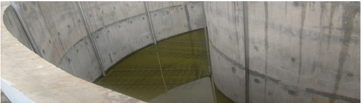
Photo VIII. Le digesteur aérobie
