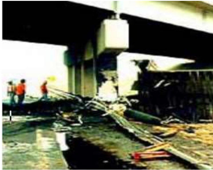
Figure 1.7. Choc sur une pile de pont.
