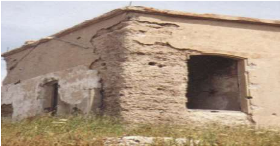
Figure 1.6. Dégradation d'un ouvrage soumis au gel dégel [19].
