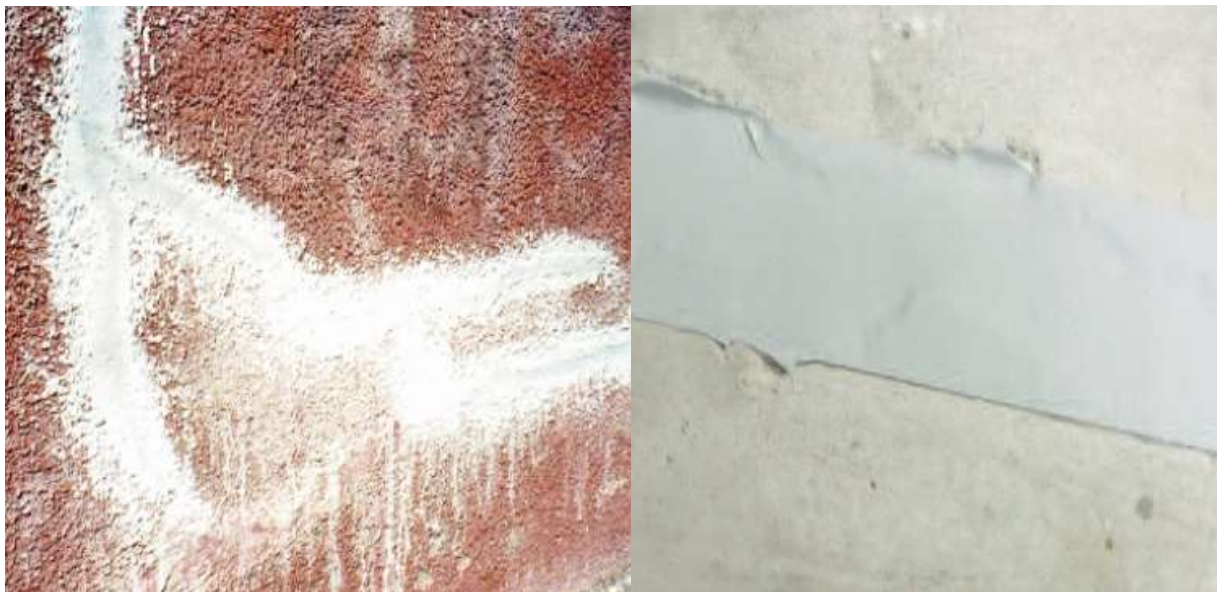
(a). Calfeutrement de fissures à l'aide d'un mortier (b) Calfeutrement d'une fissure à l'aide à base de liants hydrauliques d'un mastic à base de liants organiques
