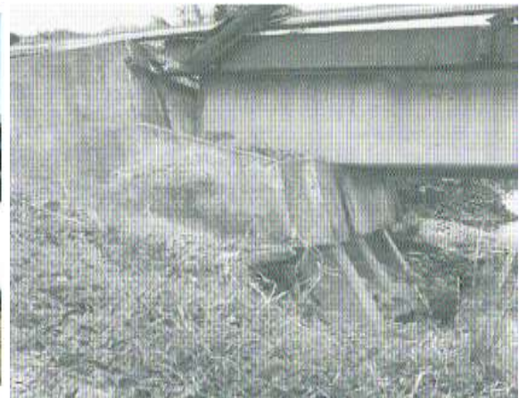
(b) Rupture par affaissement et rotation de la culée
