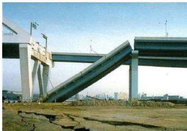
(a) Echappement du tablier (Kobe, 1995
