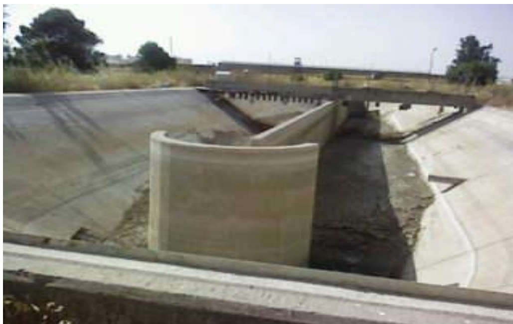
Photo N°05: Station d'épuration de l'Unité SIDI KHALED Tiaret en panne Avril 2017.
