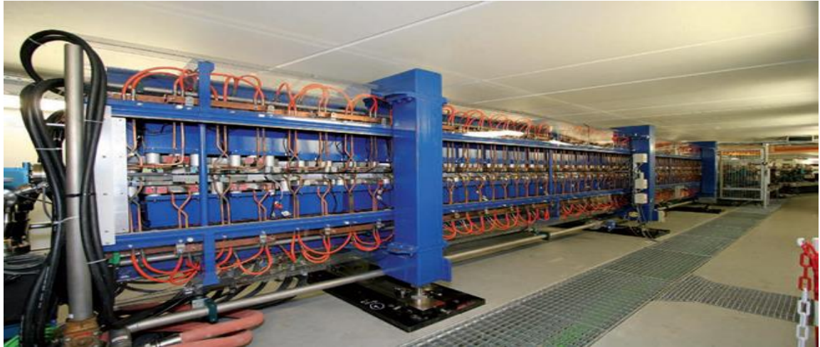
Un onduleur : HU 640 de la ligne ESIRS de SOLEIL
