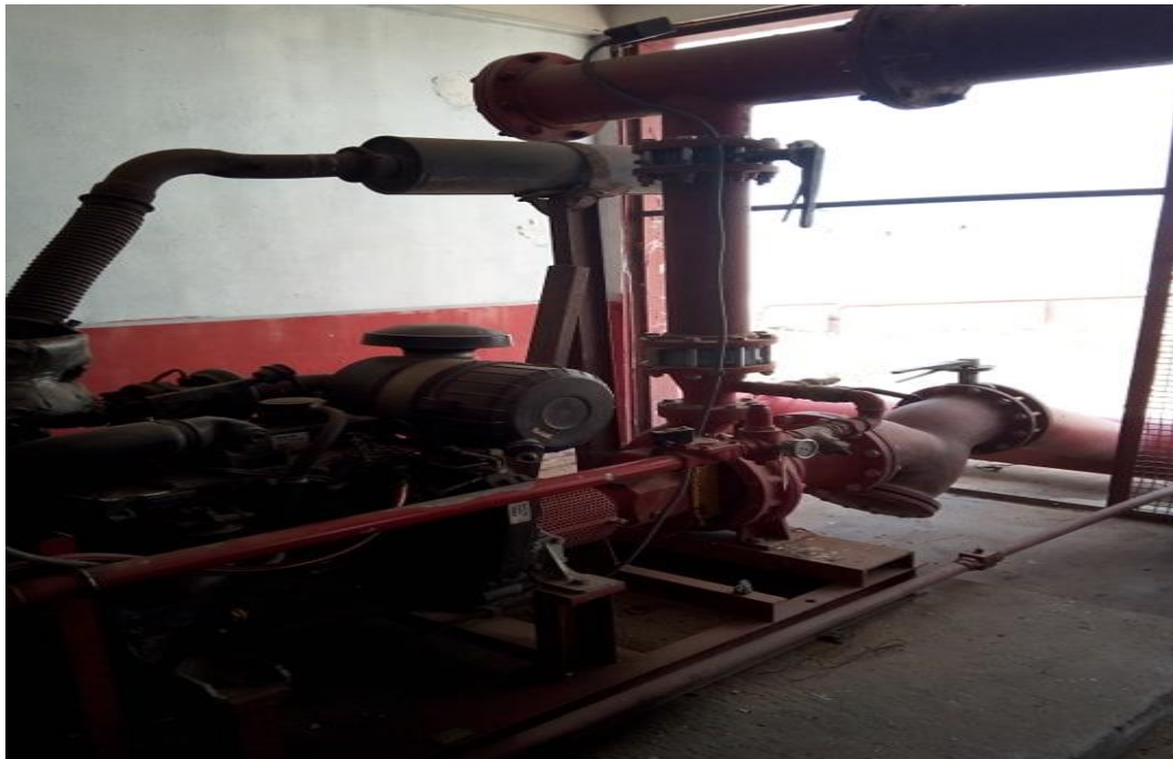
Figure IV.1 Motopompe d'incendie ingersoll [1]
