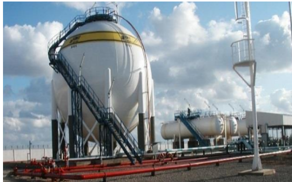
Figure I.4 réservoir de stockage GPL
