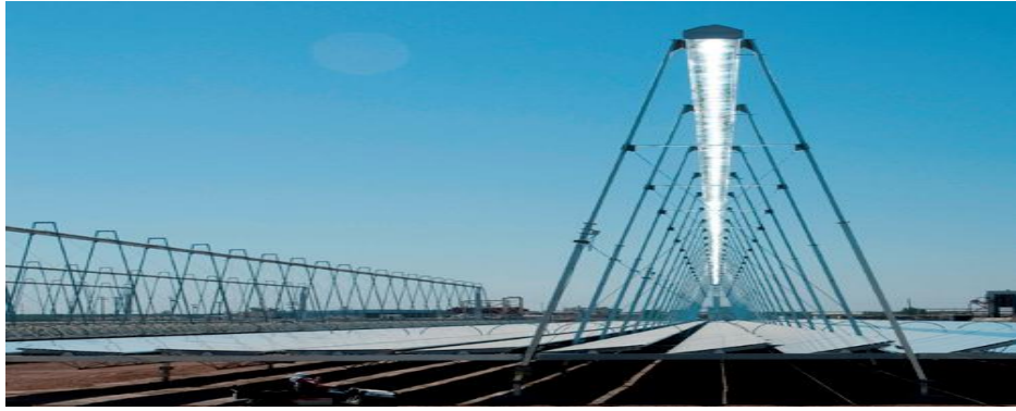
Figure I-23: Centrale solaires à miroirs de Fresnel
