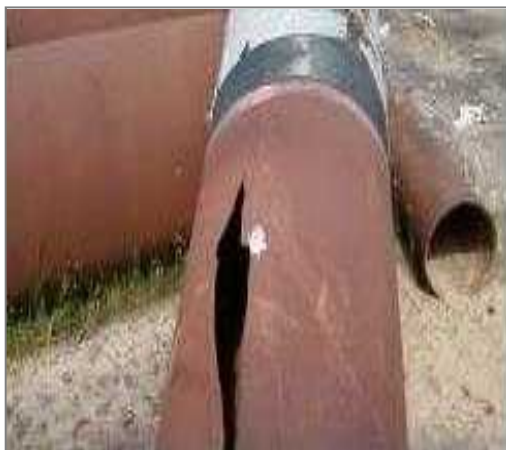
Figure 2.1 : Éclatement d'un pipeline.
