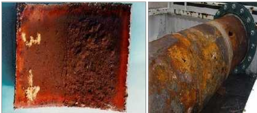
Figure 2.5 : Corrosion dans le pipeline (interne et externe).
