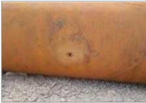
Figure 2.6 : corrosion par piquer.
