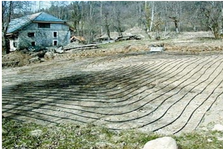
Figure I.25 : Pompe à chaleur système captage horizontal
