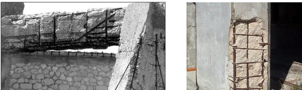
Figure I.6 : Fissuration d'un poteau et une poutre en béton armé en milieu salin. [(Yahiaoui S).2006]
