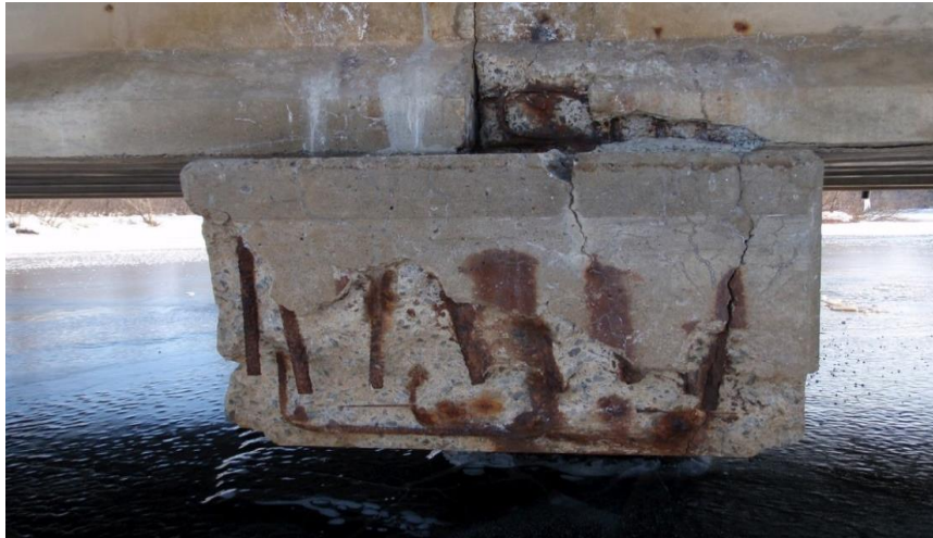
Figure I.1 : Erosion du béton [(Deghmane Y, Riou O).2018].
