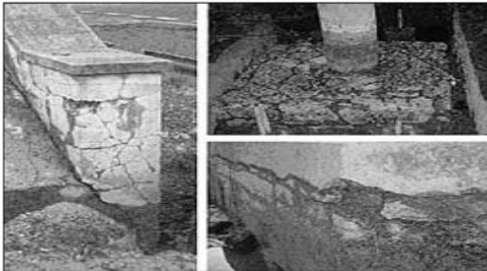
Figure I.7: Fissuration de poutres et de poteaux d'une structure âgée atteinte d'alcali réaction [(Yahiaoui S).2006]
