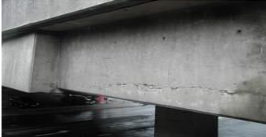
Figure I.4 : Fissurations de la poutre de pont provoquées par l'alcali-réaction [NET 02].
