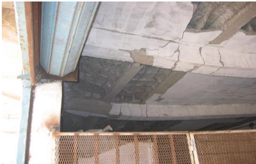
Figure I.7 : Fissurations excessives de deux poutres d'un plancher [Séisme de Boumerdes, 2003].
