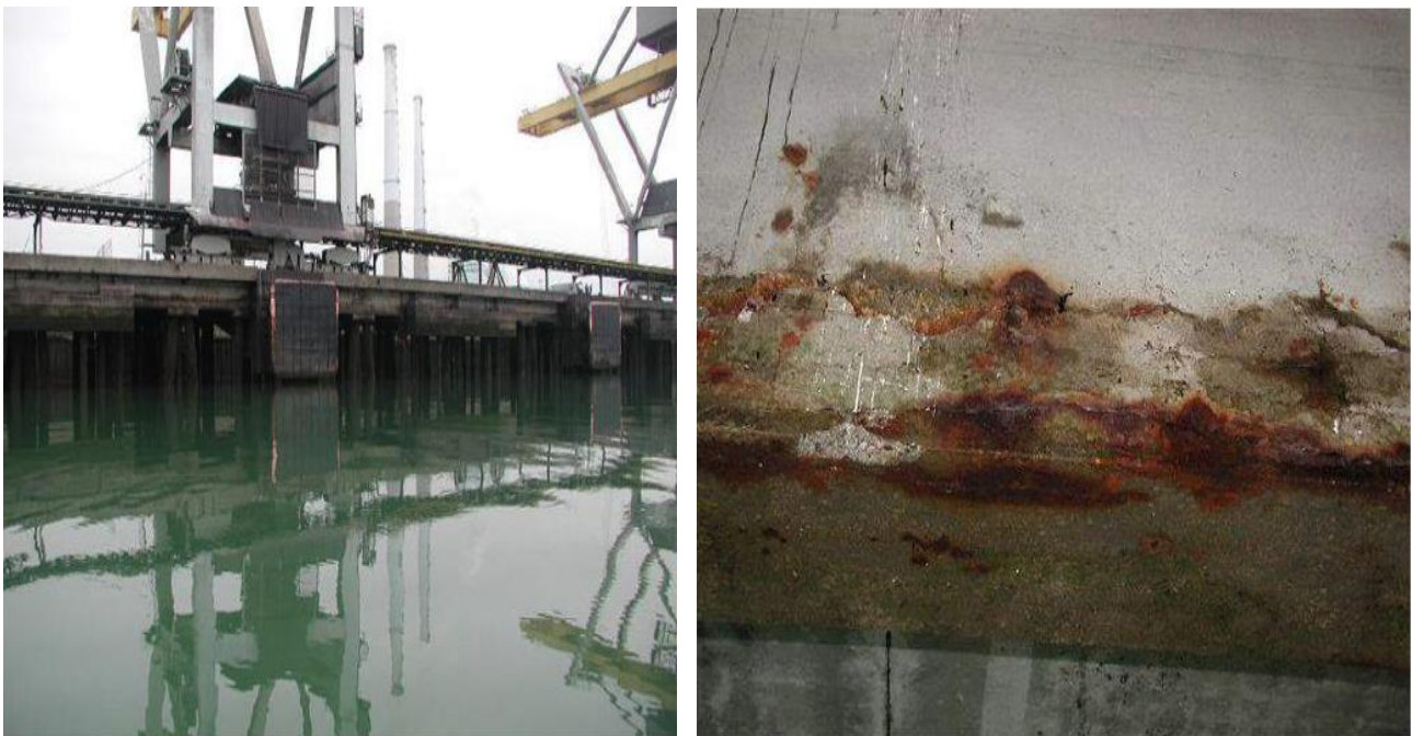
Figure I.2 : Poutre située en bord de mer sous de l'agression des chlorures [NET 01].
