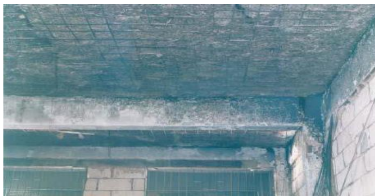
Figure I.10 : Eclatement de l'enrobage de la poutre et du plancher [Maalem , 1998]
