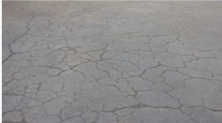
Figure I.8: Retrait du béton [Gherdaoui Moufida .2018].
