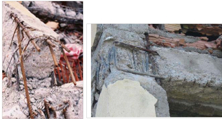
FIGURE 2.20 – Endommagement des zones critiques
