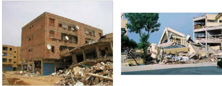
FIGURE 2.19 – Endommagement des structures par manque de ductilité
