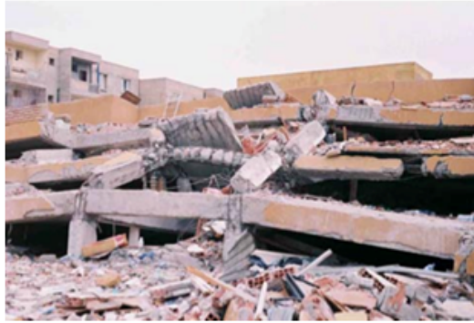
FIGURE 2.23 – Effondrement en mille feuilles
