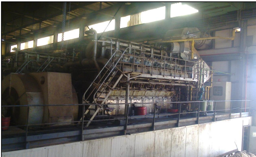
Figure II-7 : Les moteurs diesel de la centrale de Tamanrasset (5MW)
