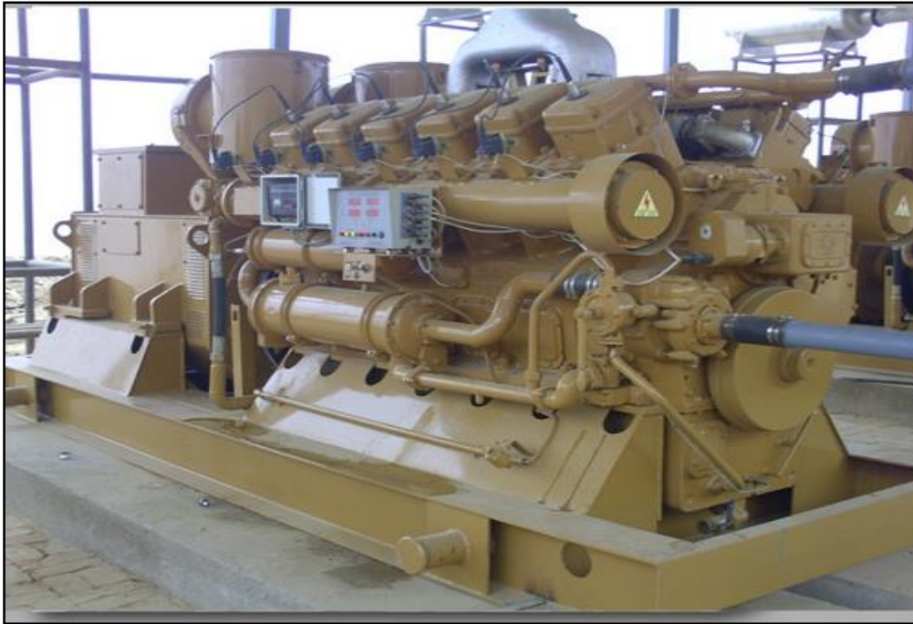
Figure II-6 : Générateur à gaz de la biomasse 2000kw
