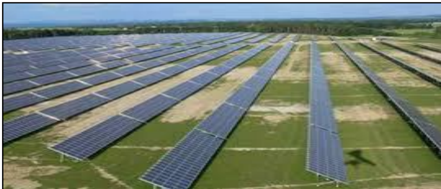
Figure II-14 : Centrale solaire photovoltaïque
