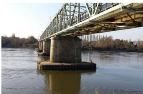
Figure I. 2: Corrosion d'un pont métallique
