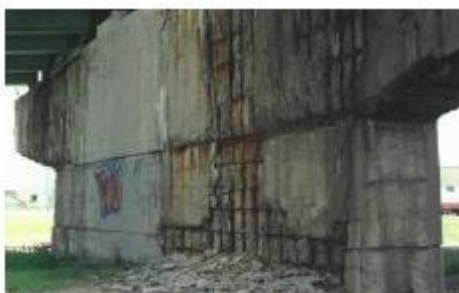
Figure I. 3: Structure atteinte par l'attaque des chlorures
