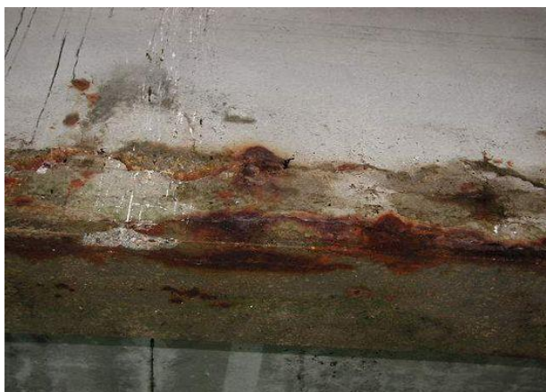
Figure I. 1: Poutre corrodé au bord de la mer
