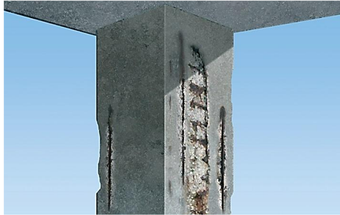
Figure I.3 : Corrosion des armateurs.
