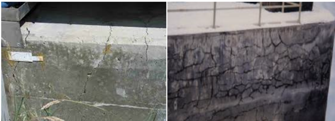
Figure I.4 : Réaction sulfurique interne dans les bétons
