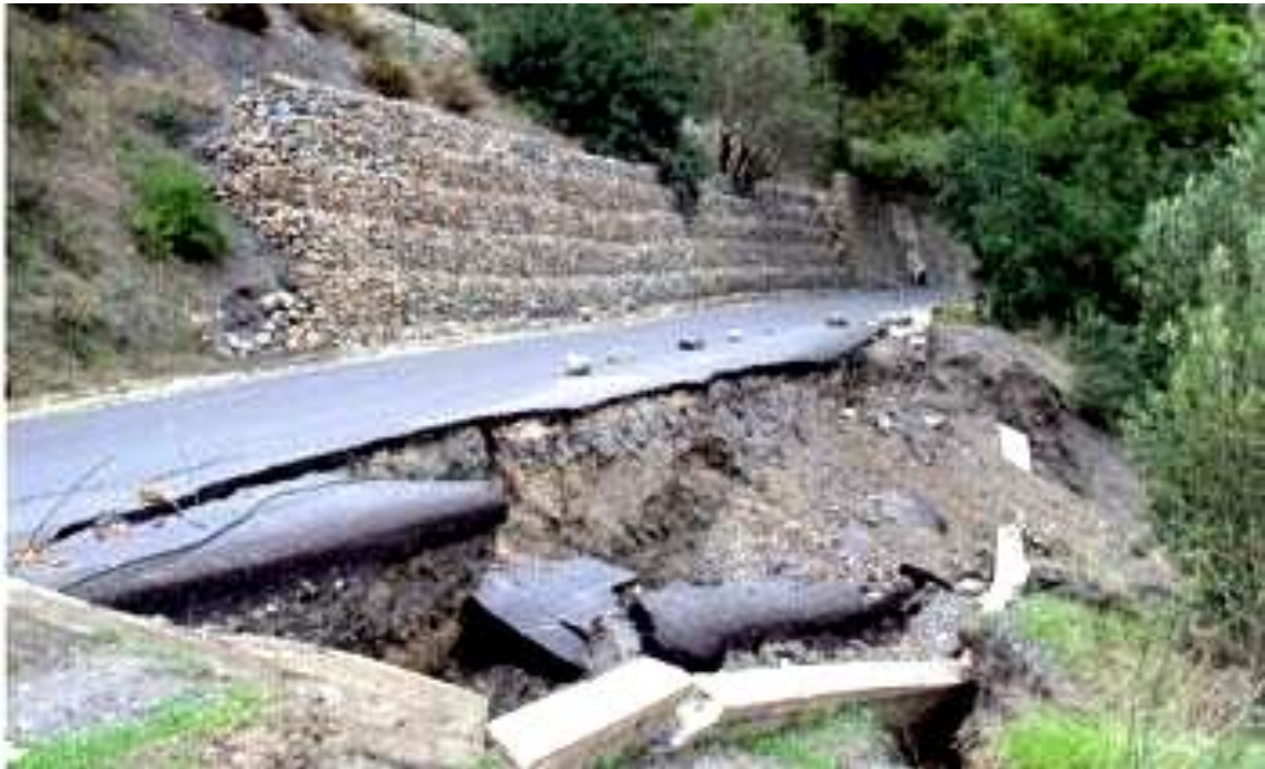
Figure II.10: Glissement de terrain à Darguina Ait Smail
