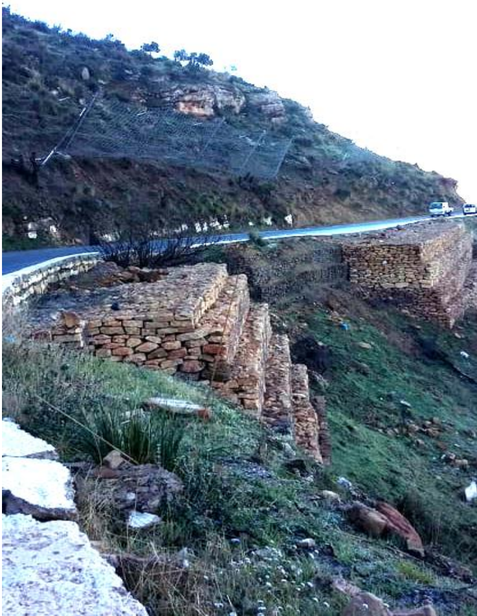
Photo V.7 : Différents systèmes de protection du talus de la route « Guertoufa »
