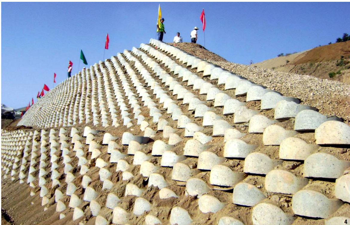
Photo V.3: Stabilité du talus parement Atalus « autoroute est ouest »
