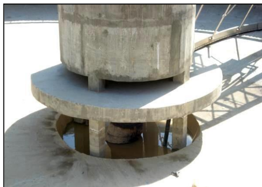
Photo III.12 : Arrivée des eaux prétraitées (jupe)
