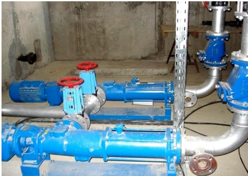
Photo III.16 : Les stations de pompage
