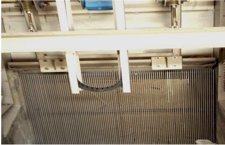
Figure III.9: Vue d'ensemble du dégrilleur fin
