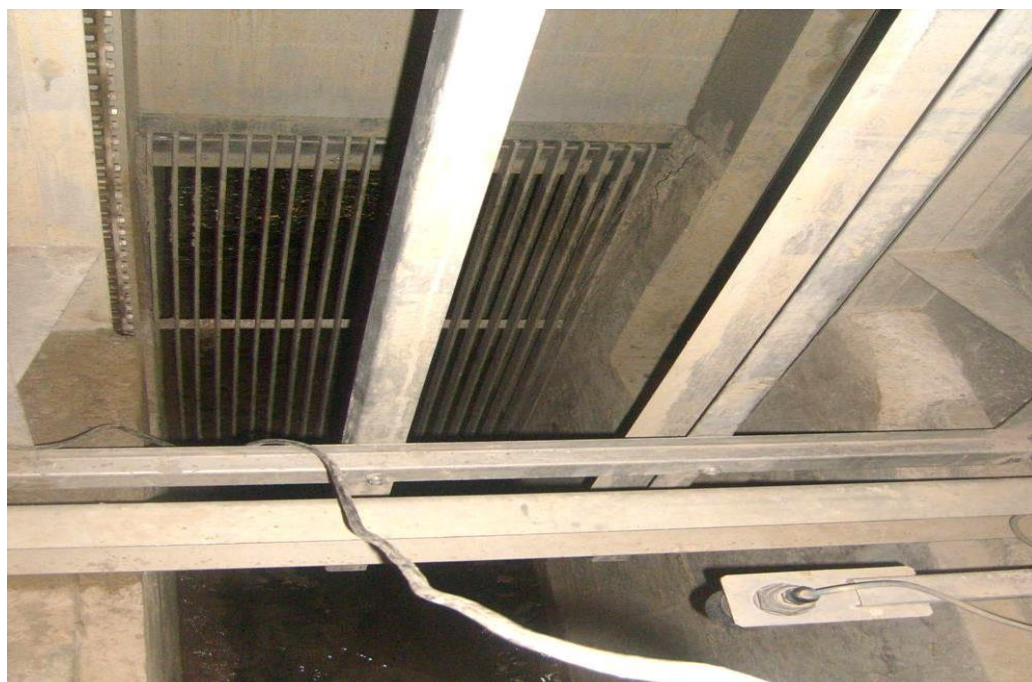
Figure III.8: Vue d'ensemble du dégrilleur grossier
