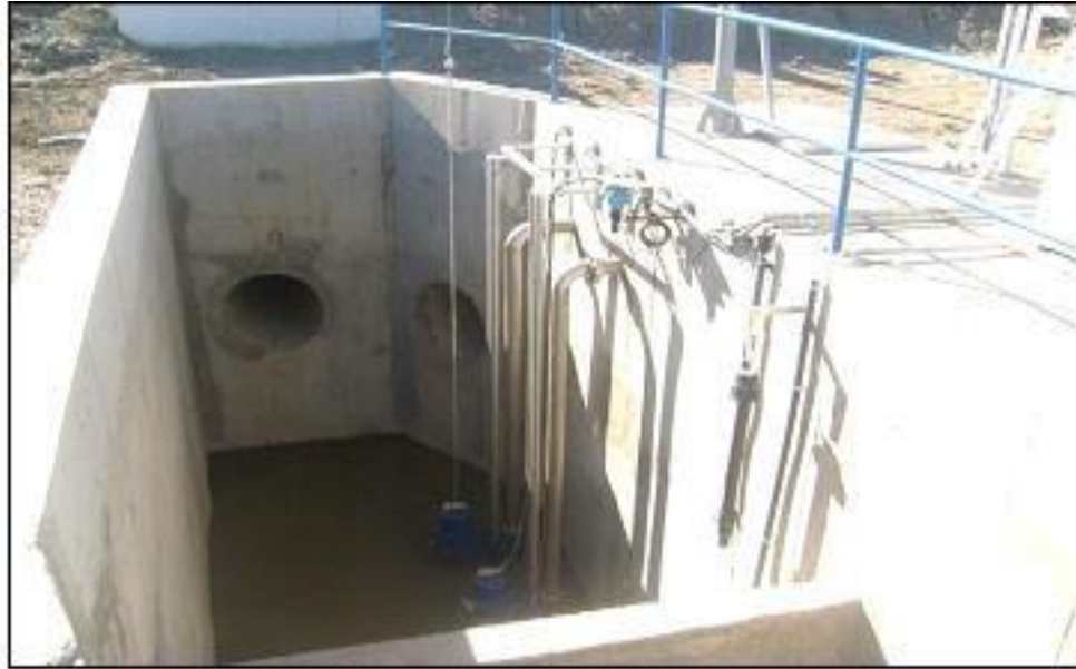
Photo III.15 : Sortie de l'eau épurée
