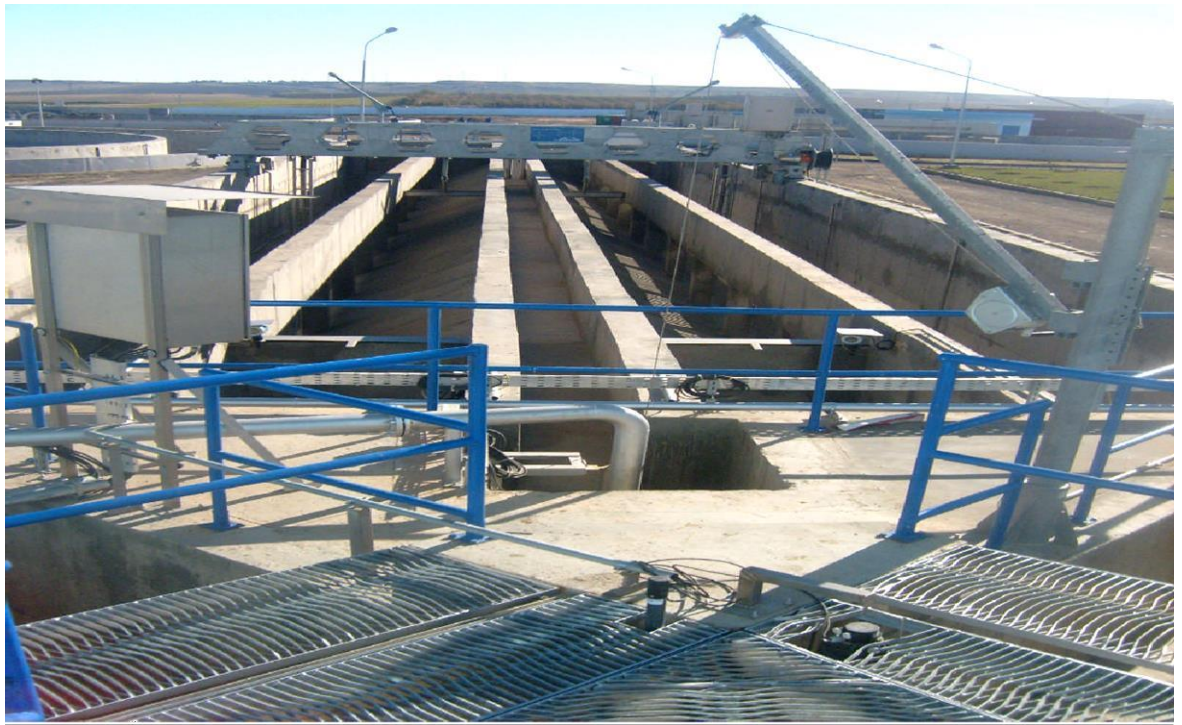
Figure III.10: Vue d'ensemble du bassin de dessablage et déshuilage de la station d'épuration des eaux usées de Tiaret.
