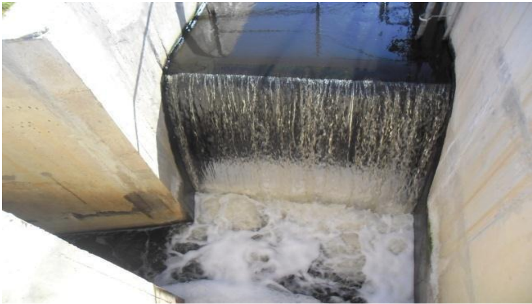
Figure IV.3 . Rejet à la sortie de la STEP des eaux épurées.
